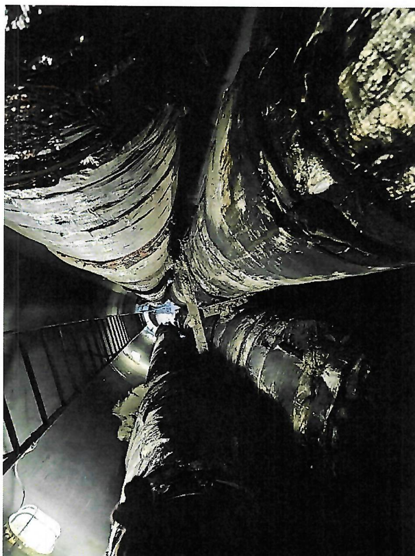
Obr. č. 28 až 30: Průduchy uvnitř komína. Technický stav izolací.
